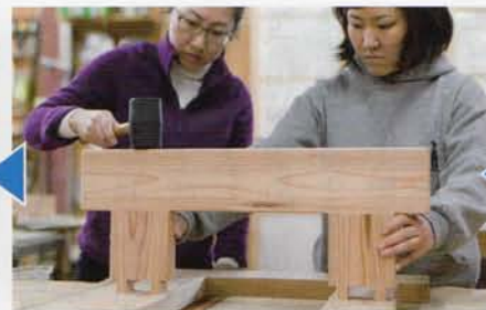
④足の製作…足となる木材同士を、それぞれ凹凸に加工して組木にする。釘金物をいっさい使用していないため、錆の心配がない
